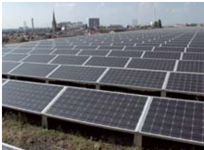
Fotovoltaische Panels auf Messehalle Basel
