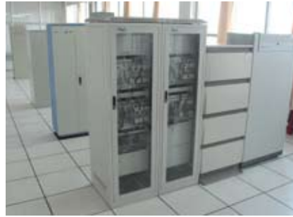
Energieverteilung und -verbrauch in Rechenzentren
